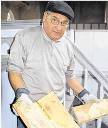
Der Schwamm „frisst“ das Holz an der Kanzelverkleidung auf.
